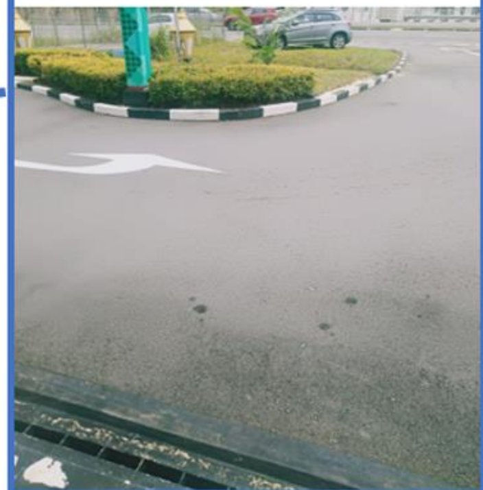
Cadangan bagi Longkang RC Drain (300mm) tidak dilaksanakan oleh pemaju.
