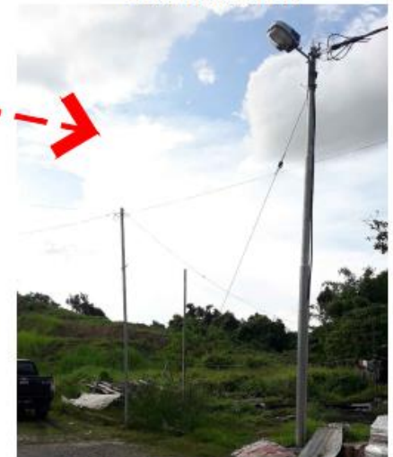
EXISTING TEL-BRU POLE
